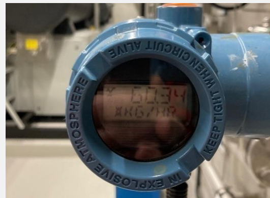
Defekter Sensor EMV Ozon Gasmessung
