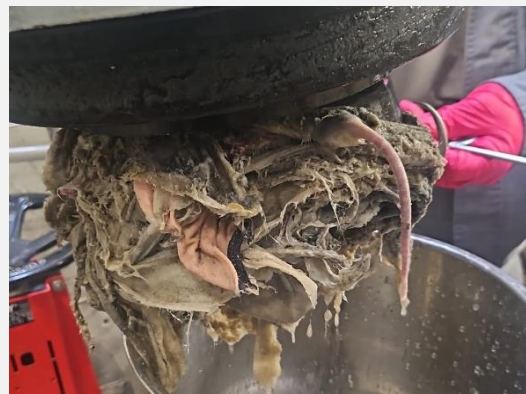
Verstopfte Pumpe im PW Werk 2
