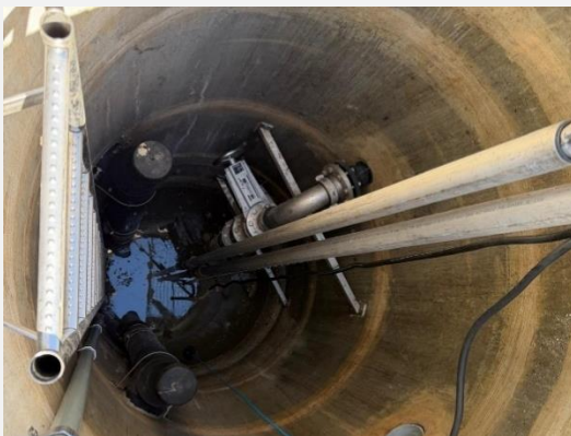
PW Wiedenhueb, Pumpenschacht
