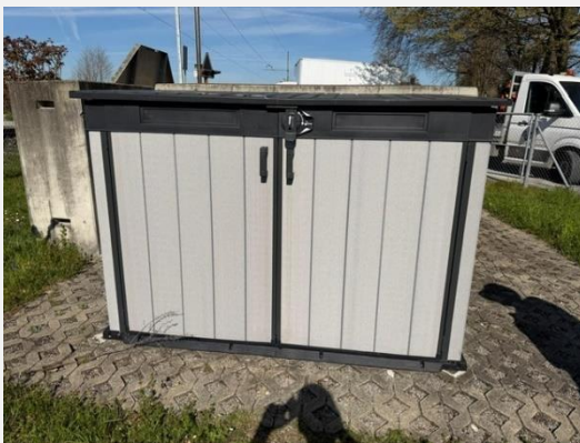
PW Kratzern, neues Gehäuse Nutrioxdosierung
