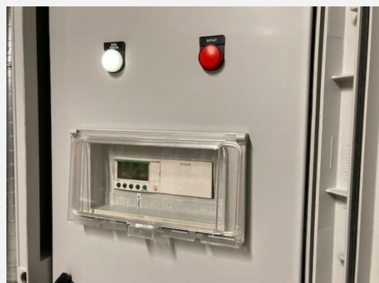
Ausfall Bedienelemente EMV
