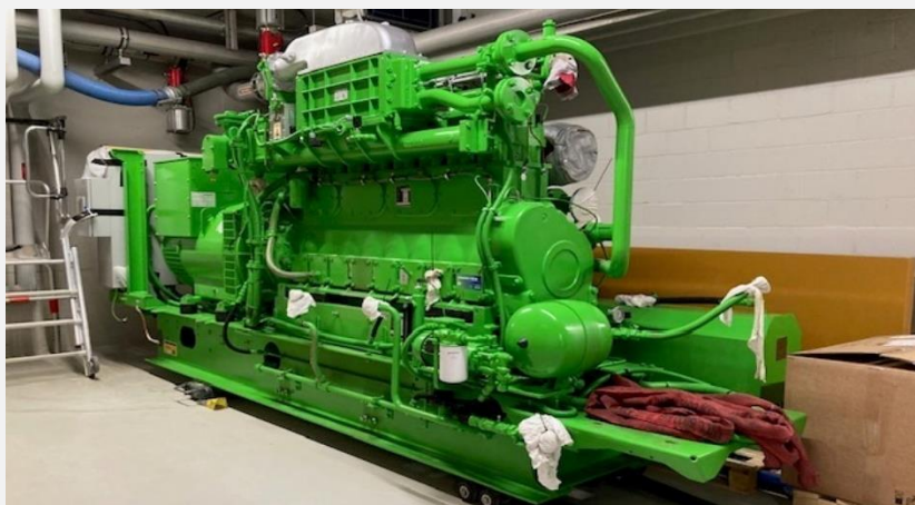
Das neue BHKW wurde bereits geliefert und wird 2026 in Betrieb gehen.
