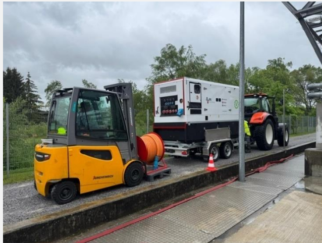
Testbetrieb mit dem Notstromdiesel (NSD) als Noteinspeisung Maschinenhaus Biologie
