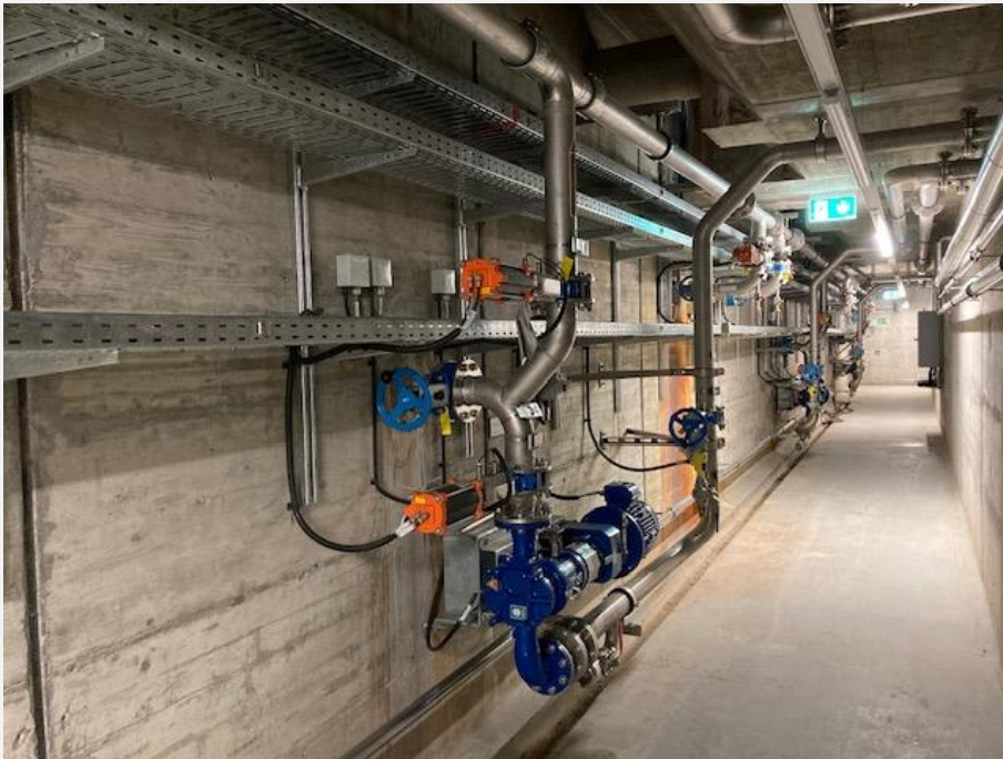
Nachrüstung zusätzliche Schieber Nachklärung für Schlammabzug
