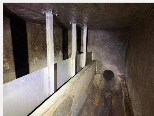
RU8910, Innenansicht mit neuer Tauchwand
