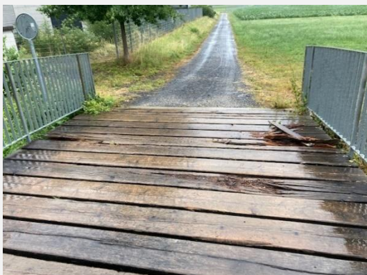
Defekte Holzbalken in der Brücke Morgental
