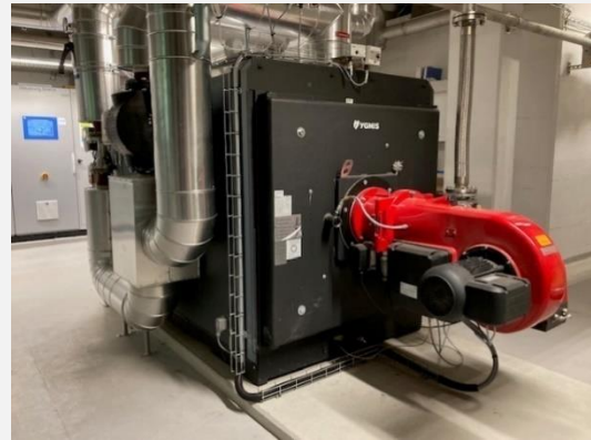
Notgasheizung in Betrieb
