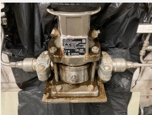
Undichte Pumpe in der EMV
