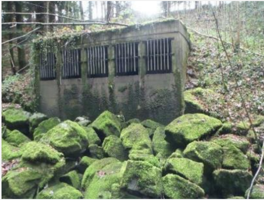
RB Mattenhof, aufgeschichtete Felsbrocken wurden weggespült
