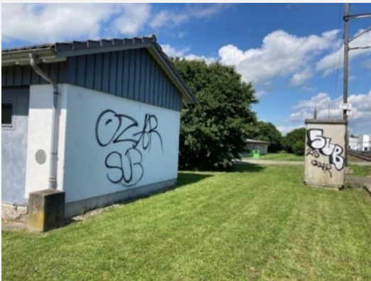
Sachbeschädigung durch Graffiti-sprayer beim HW Sais Süd...
