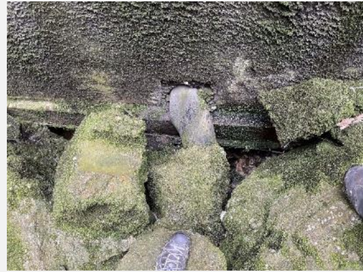
RB Mattenhof, unterspültes Bauwerk mit abgequetschter Entleerungsleitung
