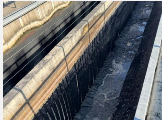
Entnahme Tauchbretter beim Sand- und Fettfang
