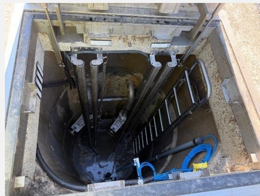
PW Haseläcker, Pumpenschacht
