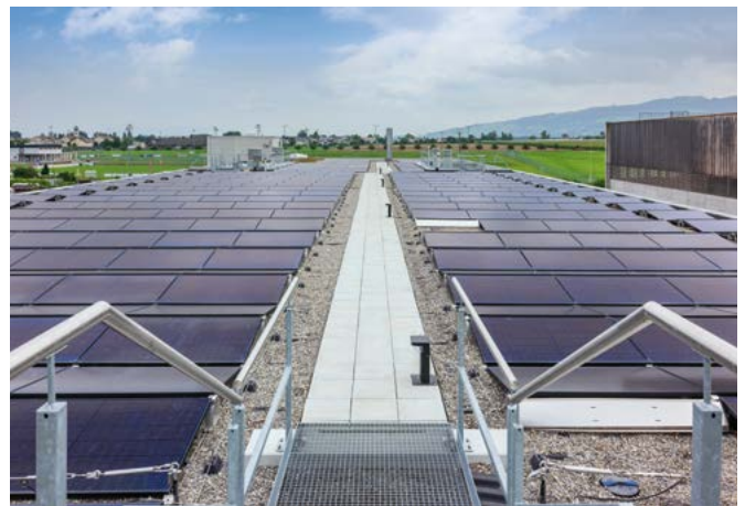
Die Leistung der 1'400 m 2 grossen PV-Anlage beträgt 188 kWp.
