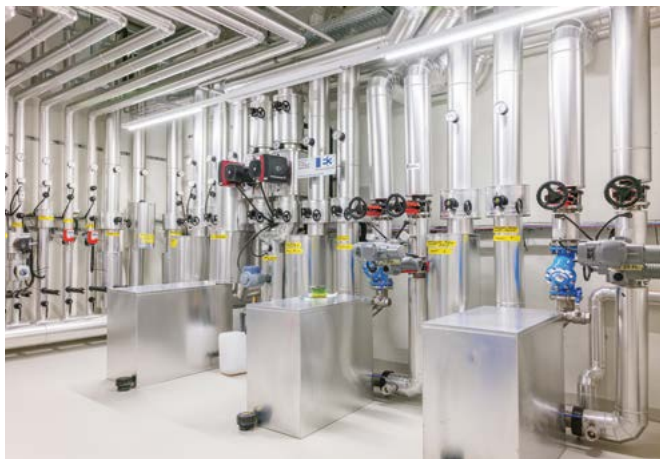
Dank der Wärmerückgewinnung muss das Gebäude nicht zusätzlich beheizt werden.
