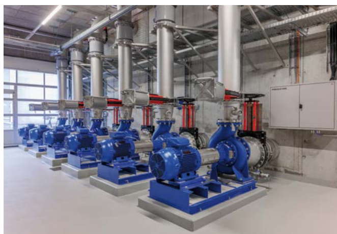
Das Pumpwerk EMV fördert das Abwasser der beiden ARA in die Ozonreaktoren.
