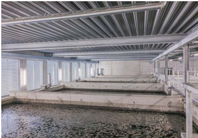
Nach der Ozonung durchfließt das behandelte Abwasser die Filtrationsstufe.
